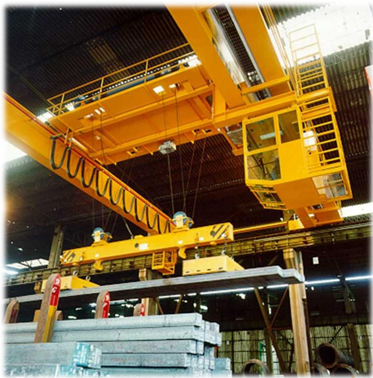
Мостовой кран с магнитной траверсой - грузоподъемность 20 тонн
